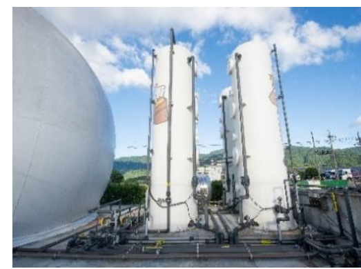
高效率生物脫硫塔
