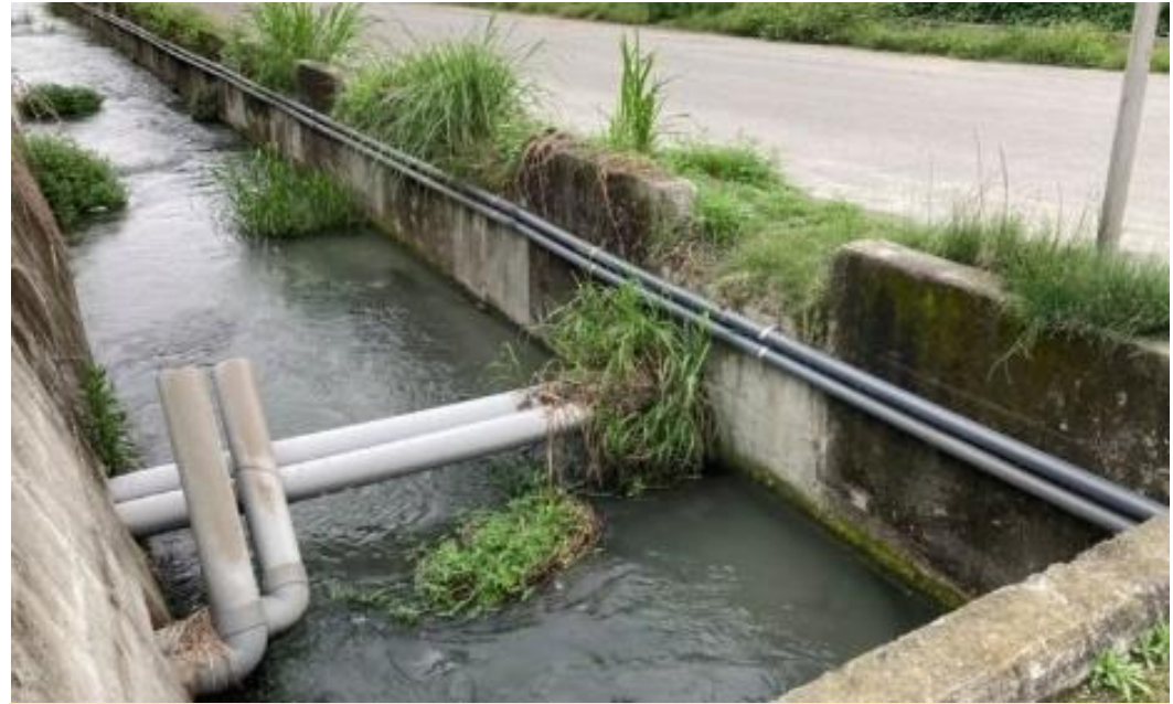
管線掛管於渠道側面
