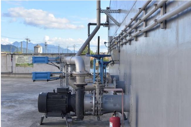
厭氧消化槽及循環泵
