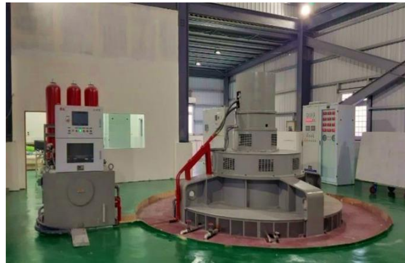
廠房內部(發電機)
