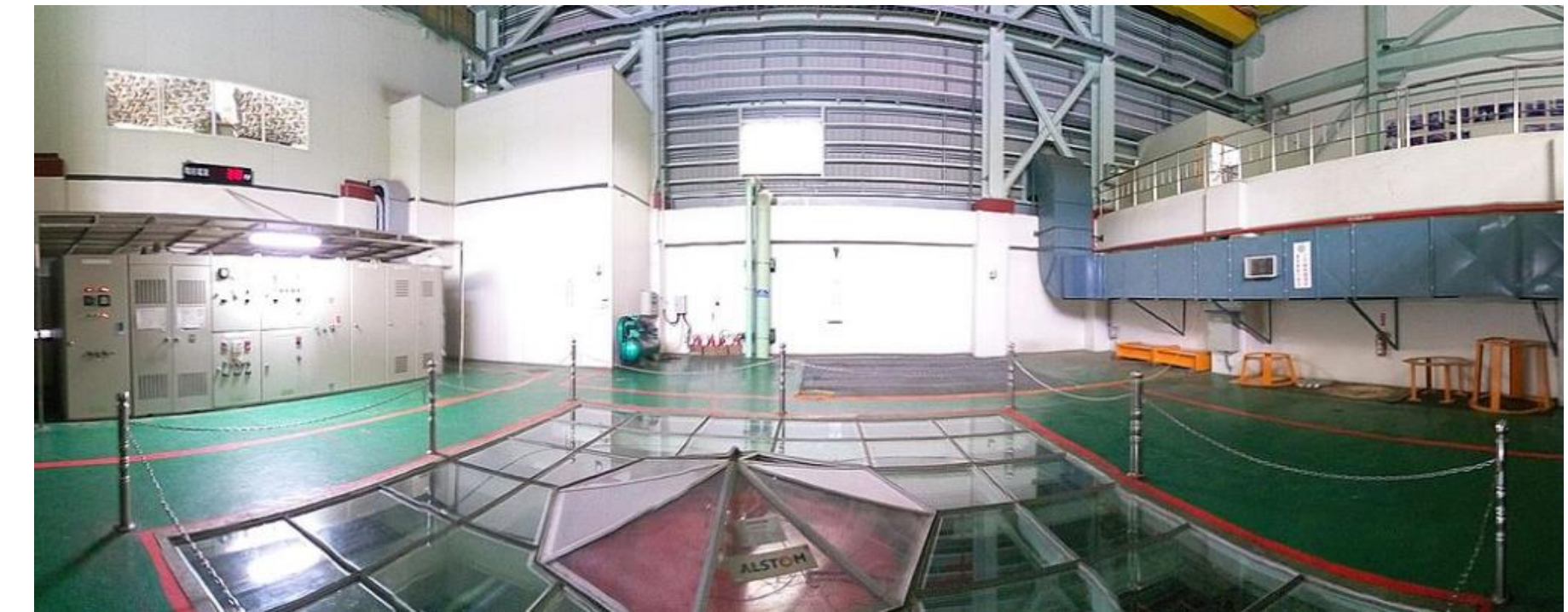
廠房內部(發電機)
