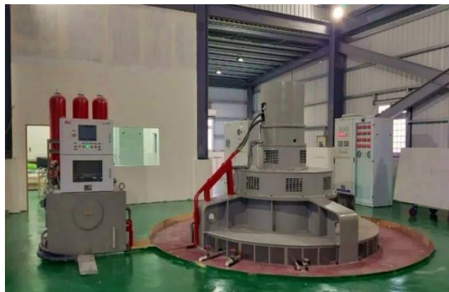
● 廠房內部(發電機)
