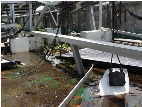
復興國小- FIT型(電纜斷裂)
