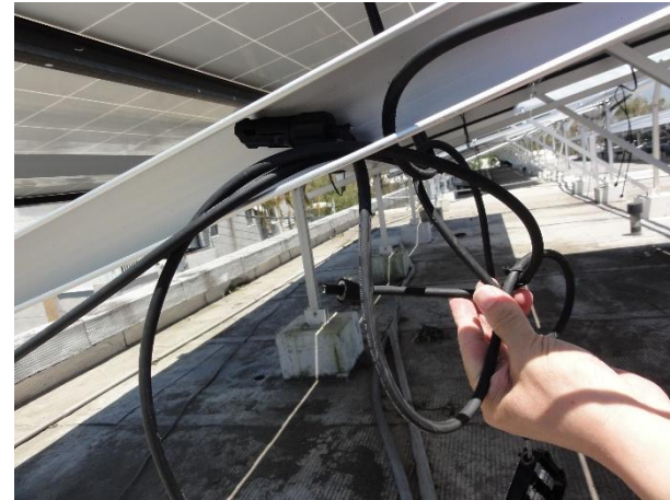
光明國小-FIT型(電纜斷裂)
